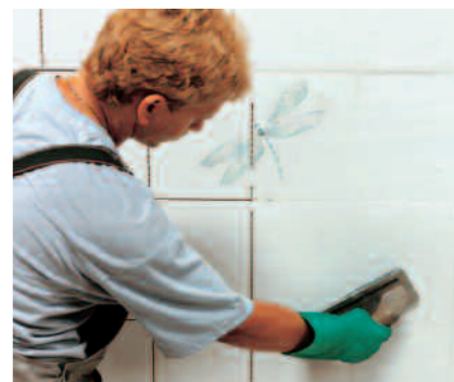
Sprickfri fogning, 2–8 mm bredd med PCI FT Fugengrau.
